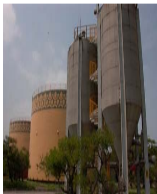
沼氣回收儲存槽
