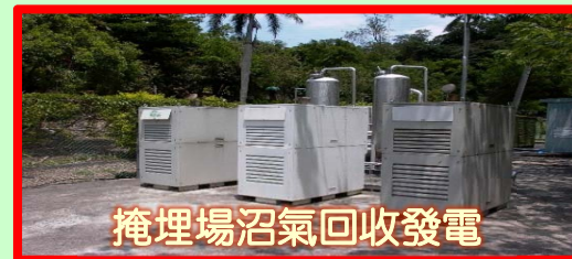
掩埋場沼氣燃燒處理
