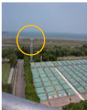
八里廠沼氣燃燒塔
